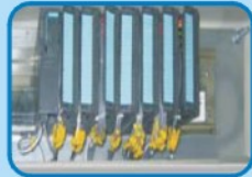
PLC自动控制系统
